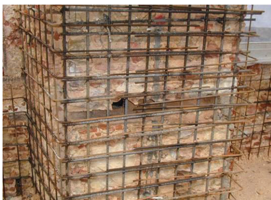
Figura 6: Reforço de colunas e paredes de alvenaria ordinária usando lâminas armadas de betão ou de argamassa cimentícia
