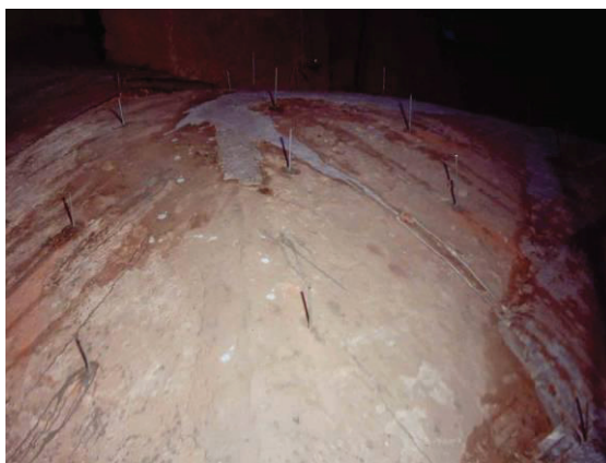
Figura 1: Fendas injectadas em abóbada fendilhada
